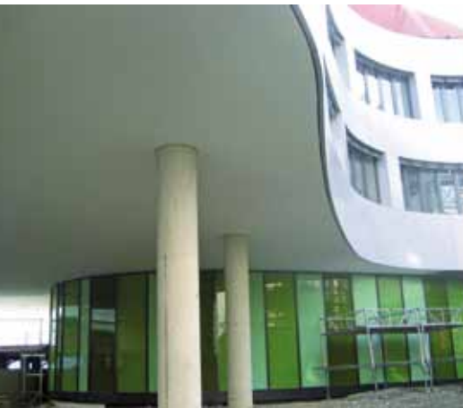
BEANSPRUCHT. Die Konstruktion ist Korrosion ausgesetzt, aber wird auch durch Windsog und Winddruck belastet.
